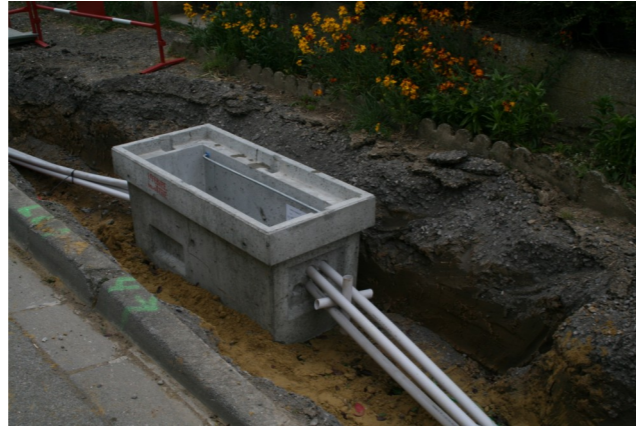
Chambre de Tirage et fourreaux pour réseau souterrain
